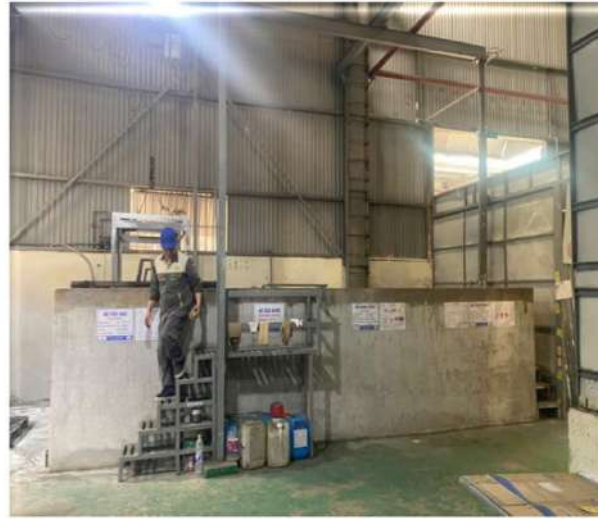
Powder Coating Area 粉体塗装エリア
